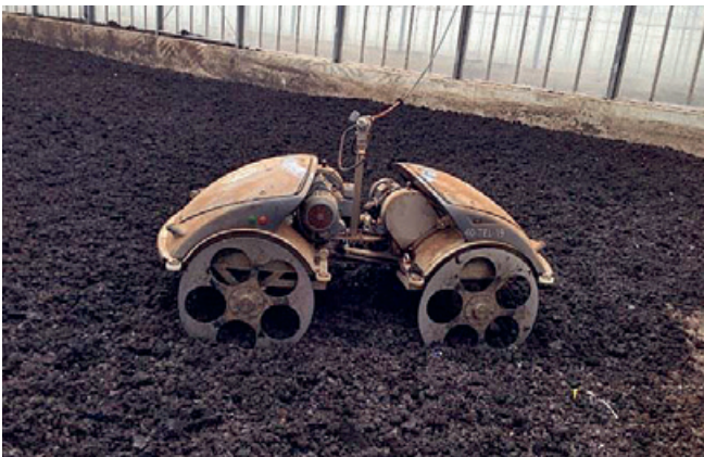
Abb. 2: Elektrischer Wenderoboter („elektorisches Schwein“ von Fa. Thermo-System) zur Wendung des Klärschlammes im Einsatz (Quelle: Emscher-Wassertechnik GmbH)
