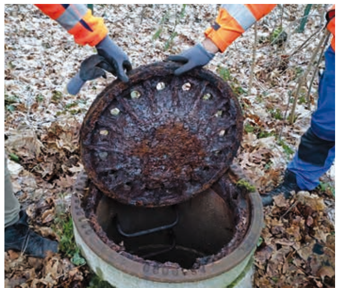
Durch H_2S -Angriff korrodiertes Kanaldeckel (Foto: Emscher Wassertechnik, I. Urban)
