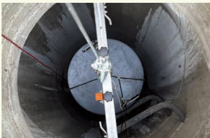
Blick auf ein eingehängtes Messsystem in einem Schachtbauwerk (Foto: ORI Abwassertechnik GmbH & Co. KG)
